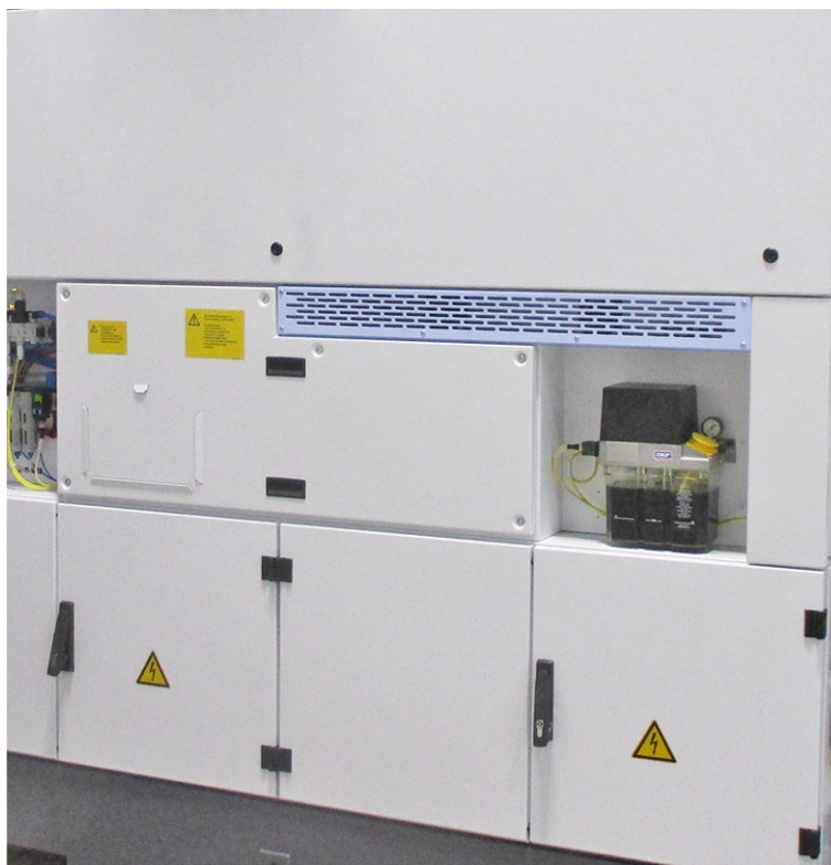
Control cabinet TNL20 Fan 1
