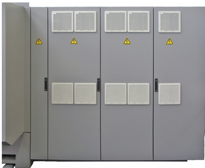
Exemple : Filtres de l'armoire électrique
